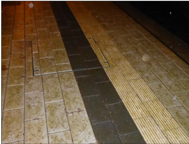
Abbildung 4: Die Bahnsteige in Scharbeutz waren durch Nässe und Vermoosung im südlichen Bereich sehr glatt.
