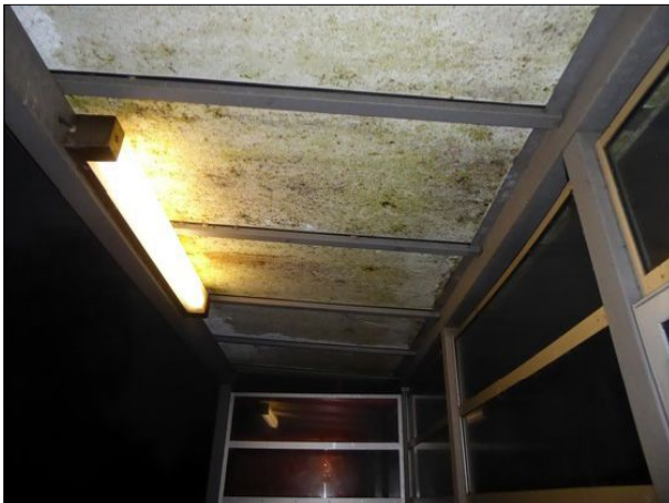
Abbildung 8: Im Unterstand von St. Michaelisdonn war neben einer fehlenden Scheibe auch die stark verschmutzte Decke zu bemängeln.
