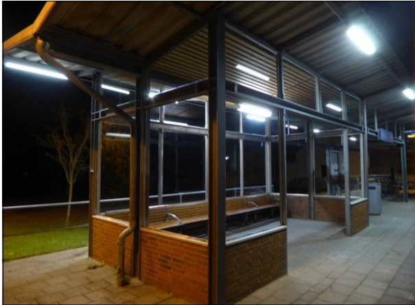
Abbildung 22: Die Glasschäden der Wartehalle in Wesselburen werden seit dem Sommer nicht mehr erneuert. Es fehlen nun schon fünf der großen Scheiben. Im Sommer waren es erst zwei.
