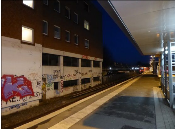
Abbildung 23: In Wedel beeinträchtigen seit Jahren die Schmierereien an der Hauswand neben Gleis 1 das Erscheinungsbild.
