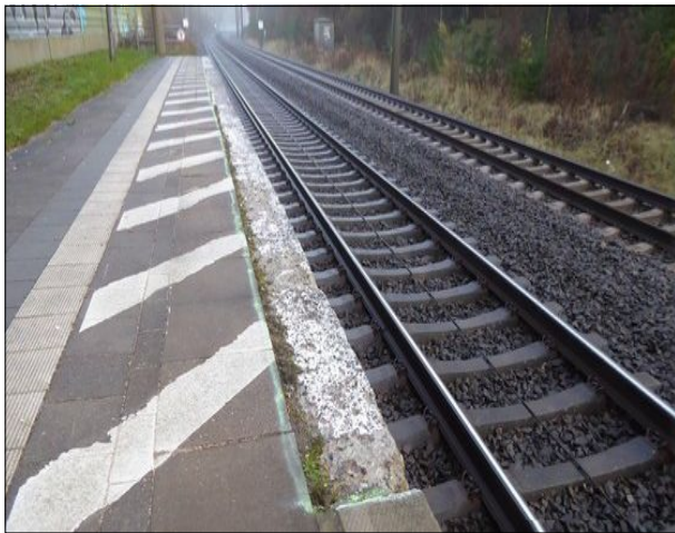
Abbildung 5: In Friedrichsruh ist die Bahnsteigkante am östlichen Ende des Hausbahnsteigs stark beschädigt. Die Abdecksteine fehlen.
