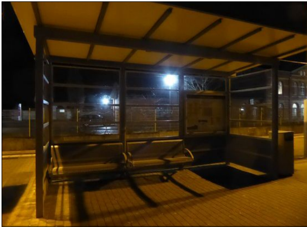
Abbildung 7: Im Fahrgastunterstand von Bredstedt war die Beleuchtung defekt. Die Aushänge in der Vitrine waren nicht lesbar.
