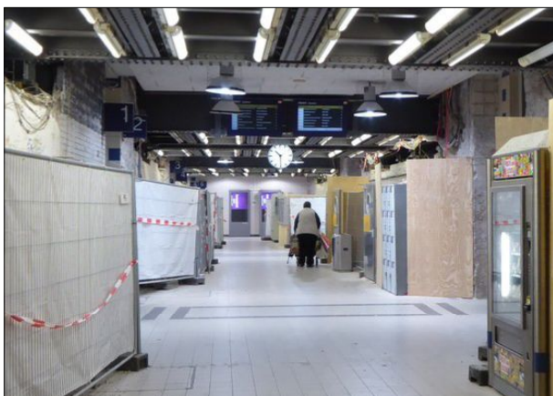
Abbildung 45: Im Tunnel von Neumünster mussten die Fahrgäste Beeinträchtigungen durch Revisionsarbeiten hinnehmen. Eine Information der Reisenden durch Aushänge gab es nicht.
