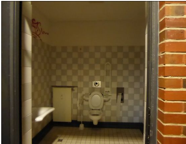
Abbildung 37: Das Licht in der Toilette des Bahnhofs Bad St. Peter-Ording war defekt. Bei geschlossener Tür wurde es darin dunkel.
