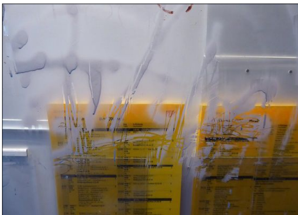
Abbildung 30: Die Vitrine im Warteraum des Bahnhofs Burg (Dithm) war beschmiert.
