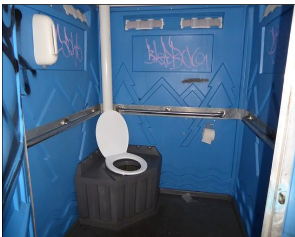
Abbildung 39: Das seit Jahren am Bahnhof Ratzeburg „provisorisch“ aufgestellte Dixi-Klo war bekratzelt.
