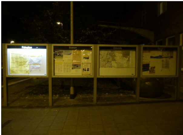
Abbildung 53: In drei Vitrinen an Gleis 1 in Bad Schwartau war die Beleuchtung defekt.
